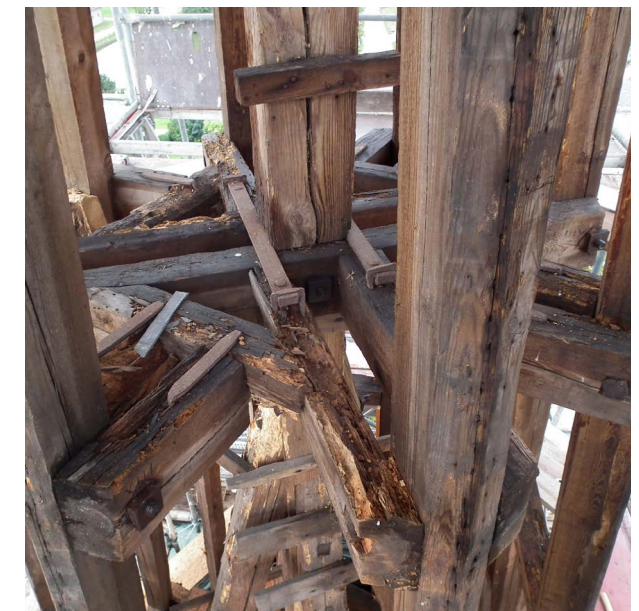
Starke Schäden an der Holzkonstruktion am Kirchturm in Hohen Demzin
